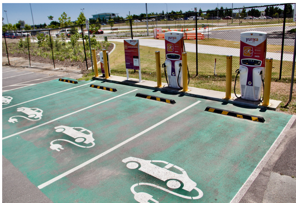
Publika laddstolpar som är del i Queensland's Electric Super Highway.
